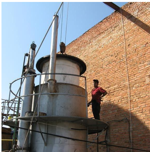
Наладка первого модуля оборудования
